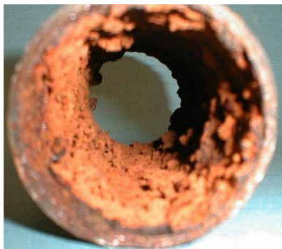
Fig. 1: Proceso de corrosión
